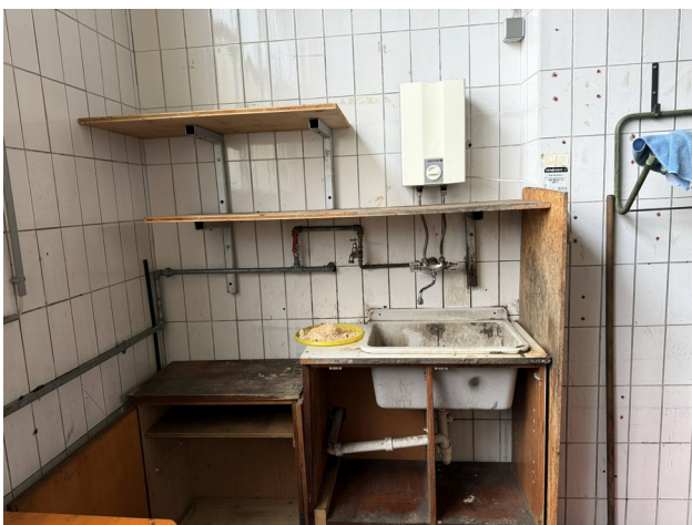
Waschbecken mit Warmwasserboiler
